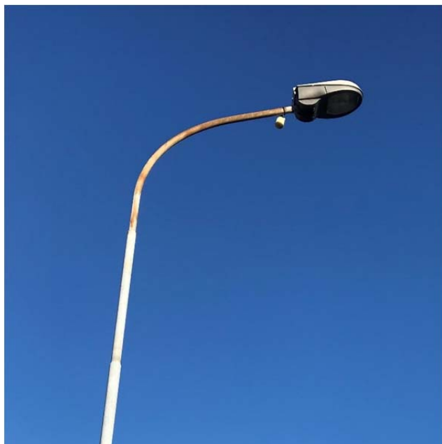
Armatura stradale con vetro di chiusura piano per lampada al sodio installata su palo curvo
