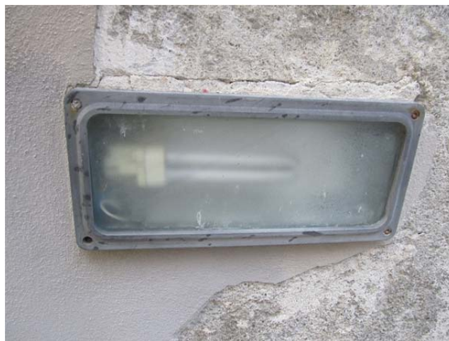
Apparecchio ad incasso a parete installato nella frazione di Serone (rif. dal C_17). L'apparecchio presenta segni di deterioramento estetico più che funzionale.
