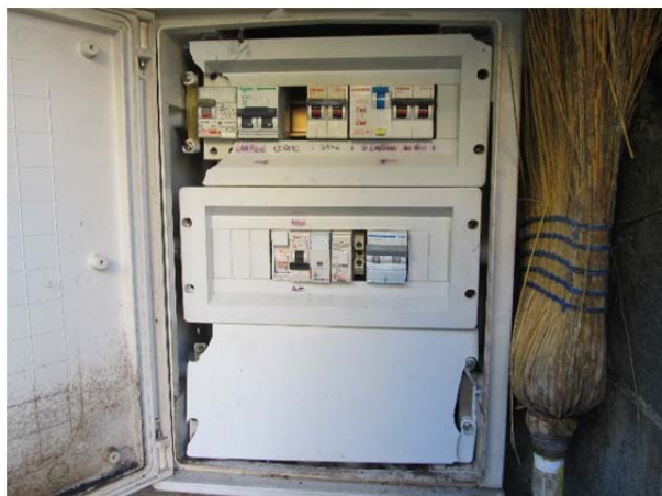
Quadro IP Comunale in Classe II, in esecuzione da parete (da sostituire)
