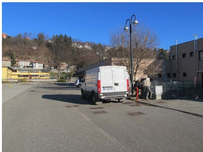
Punti luce di recente installazione con lampada ad alogenuri installati nell'area commerciale di via B. Sella a Pray
