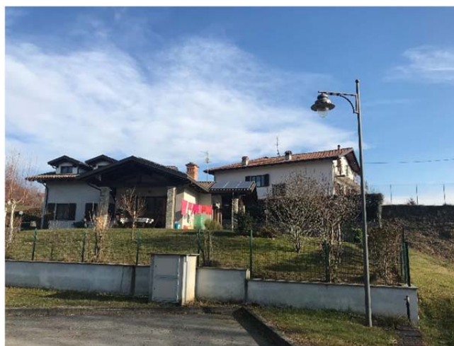
Punti luce di recente installazione luce con lampada al sodio ad alta pressione installati nell'area adibita a parcheggio di via Don Galli a Flecchia
