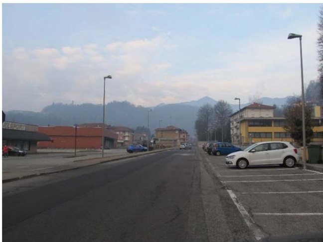
Punti luce di recente installazione a LED di proprietà comunale installati a Pray in via B. Sella.
