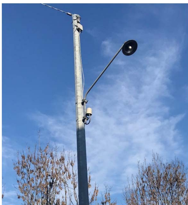
Armatura stradale obsoleta priva di vetro di chiusura per lampada a vapori di mercurio installata su palo in cemento
