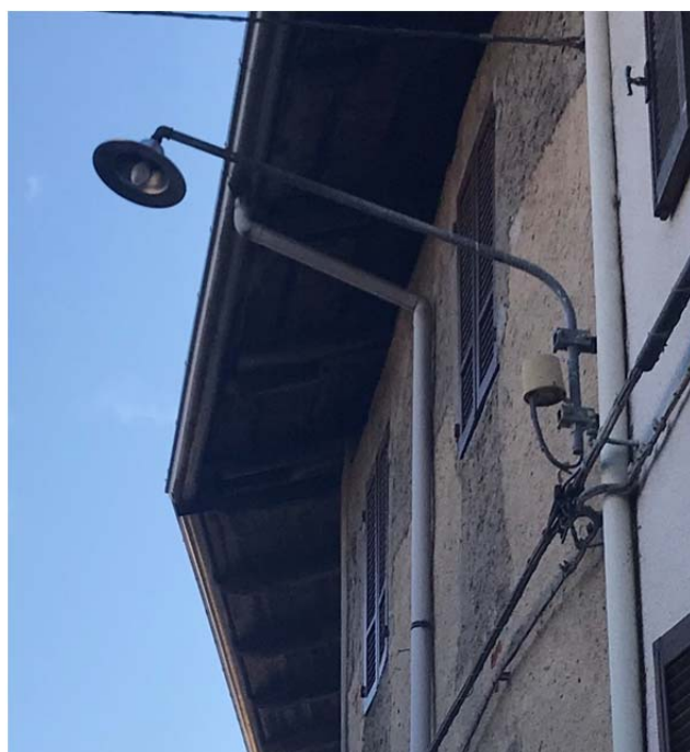
Armatura stradale obsoleta priva di vetro di chiusura per lampada a vapori di mercurio installata su braccio a parete
