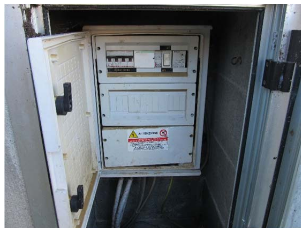
Quadro IP Comunale in Classe II, in esecuzione da parete (da mantenere)
