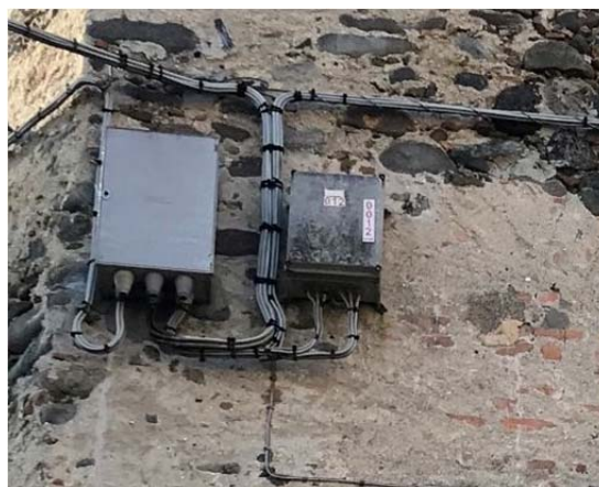
Quadro IP Enel Sole, in esecuzione da parete (da sostituire)
