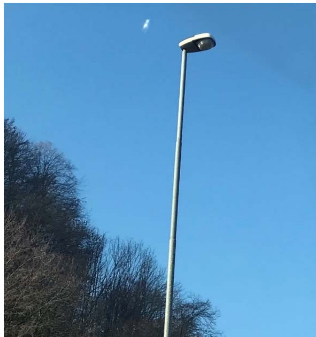
Armatura stradale con vetro di chiusura curvo per lampada al sodio installata su palo zincato
