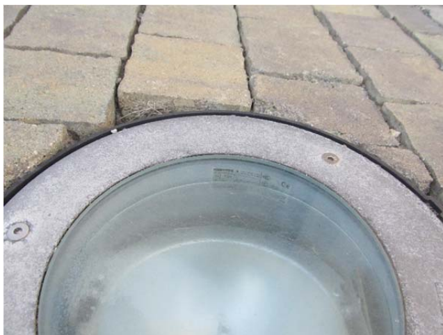
Incassi a terra installati nella frazione di Serone per l'illuminazione della facciata della sede comunale (rif. dal C_18 al C_23). Gli apparecchi presentano notevoli segni d'usura del vetro di chiusura che ne compromette il rendimento luminoso
